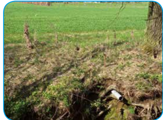
Tuyau de drainage.
